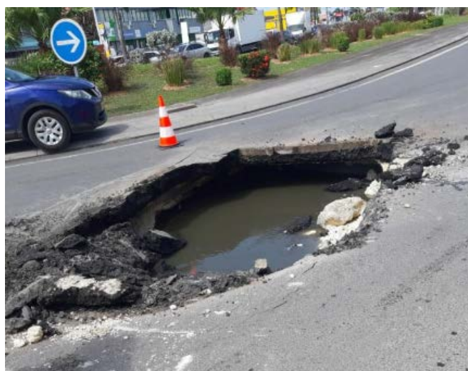
Figure 31 : Affaissement de la chaussée rond-point haricot à Jarry en février 2021 (source : Canal 10)
