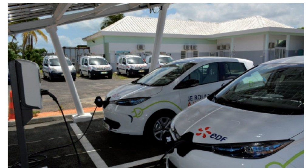
Bornes de recharge des voitures électriques - dispositif DRIVE Source : EDF Antilles
