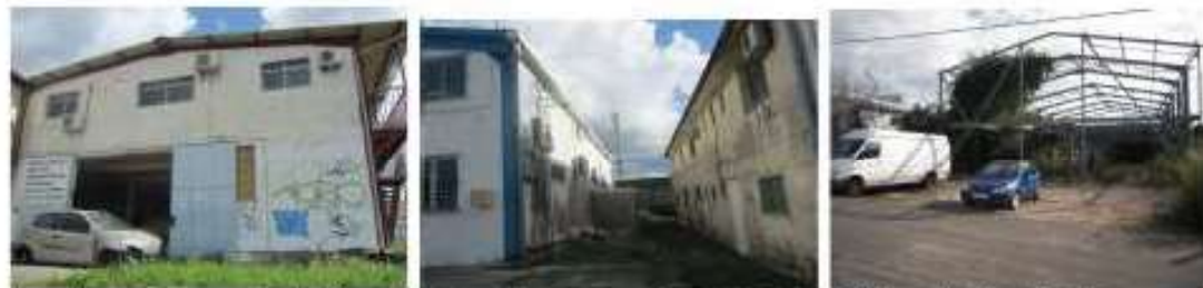
Façades en mauvais état
