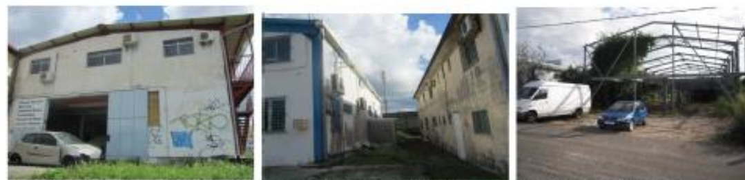
Façades en mauvais état
