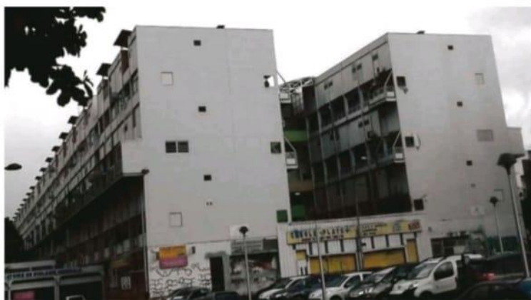
Vue des bâtiments 1 et 2 de la Résidence des Lauriers (Pointe-à-Pitre) en 2013. Anthony BASSIEN CAPSA
