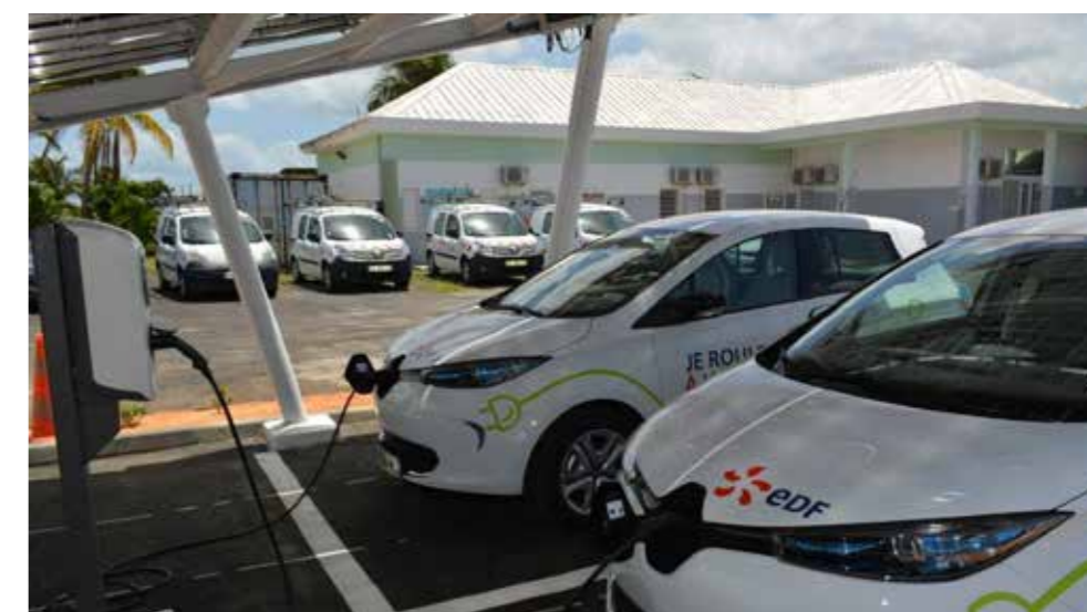
Bornes de recharge des voitures électriques - dispositif DRIVE
