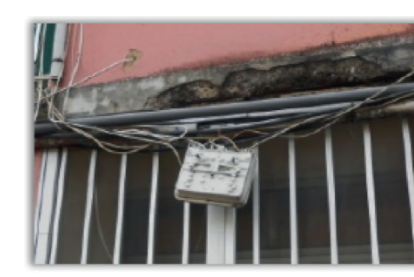
Câbles électriques facilement accessibles sur la façade d'un immeuble (Bergevin)
