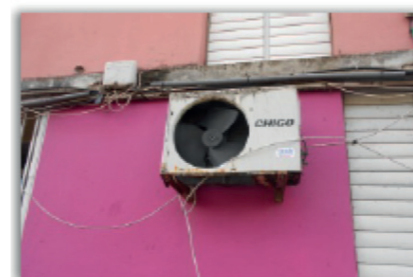
Unité extérieure de climatisation dégradée : rouille, sans cache de protection (Bergevin)
