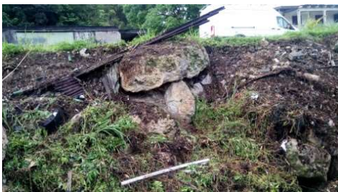
Exemple d'obstruction à BOISVIN
